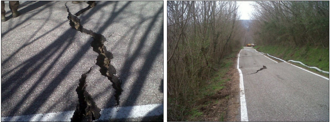
Lesioni del manto stradale – Via di Arcigliano (2013)
