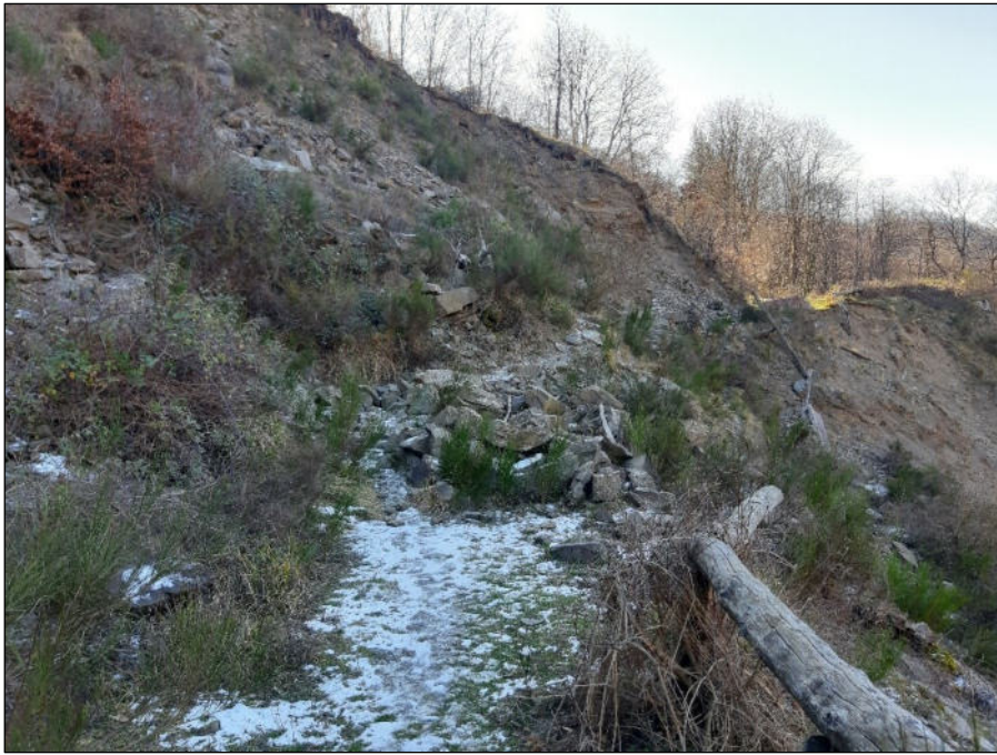
Foto sopralluoghi (gennaio 2022): presenza di massi caduti lungo il versante
