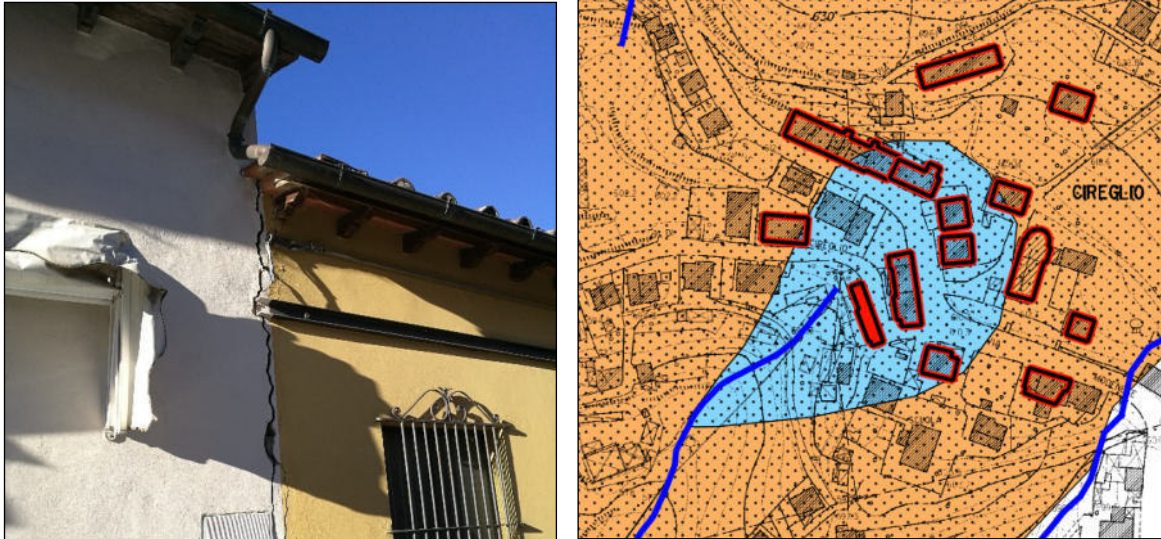
Sinistra: esempio di lesione strutturale; destra: ubicazione del corpo di frana attivo (celesti) e degli impluvi della zona. Sono inoltre messi in evidenza gli edifici censiti (il poligono rosso indica l'edificio con la lesione mostrata nella foto a sinistra)
